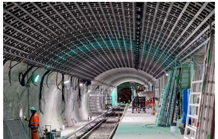
Abb.: Spezielle »Lichtpunkthalter« mussten entwickelt werden. Die aus den Trägern auslaufenden Fasern wurden im Konnektor zusammengefasst, poliert und der jeweiligen Lichtquelle zugeordnet. Foto: A. Reetz-Graudenz
